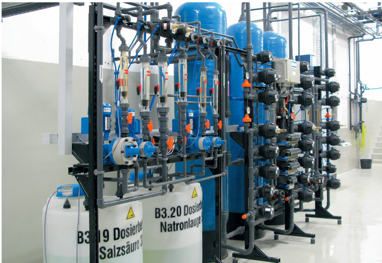
Diese Anlage ermöglicht die Metallrückgewinnung aus Spülwässern.
