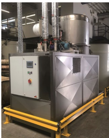
Je nach Art des Abwassers werden unterschiedliche Materialien verwendet.
